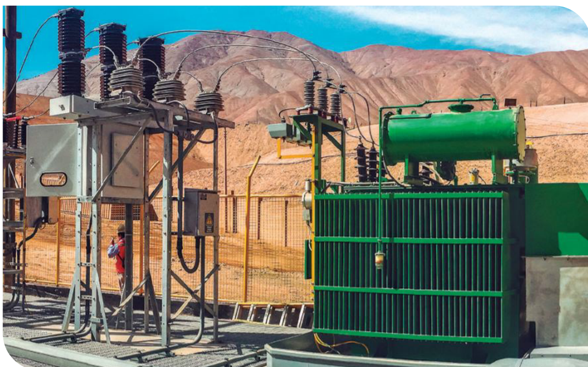
Subestación eléctrica tocota - Minera Caravelí, con transformador refrigerado en aceite vegetal
