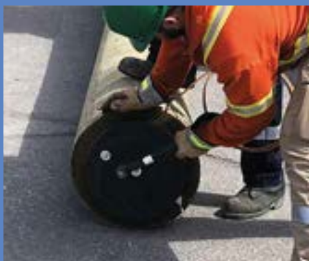
Asegurar al poste
