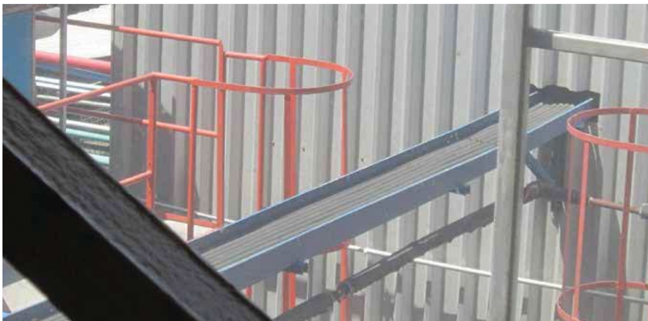
SUPERFLEX instalado en bandejas.
